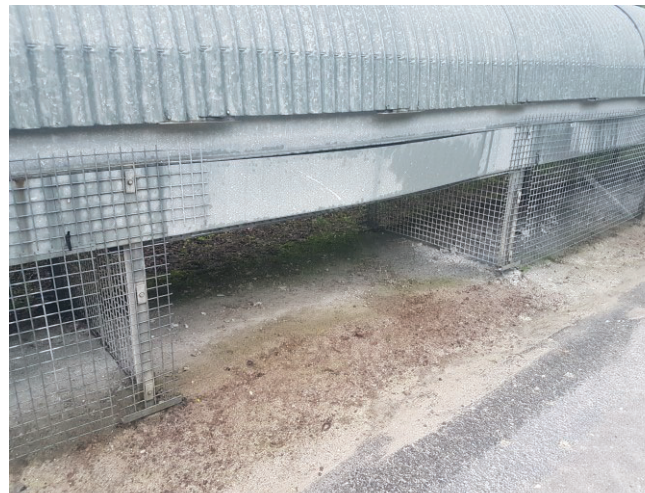
Abb. 13: Beispiel für eine eingehauste Bandanlage
